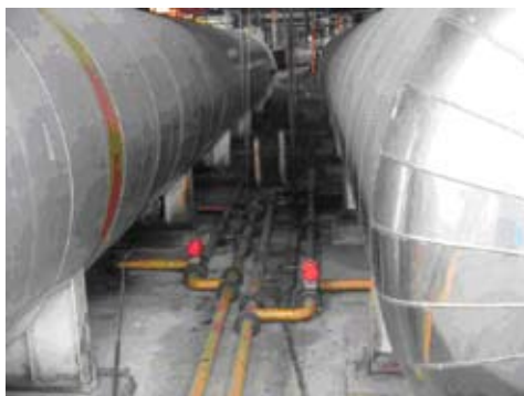
Foto 1. Aceites S.A. Descarga de condensados de esterilización.
