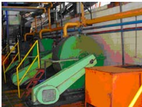
Foto 6. Palmeras de la Costa S.A. Centrífugas
