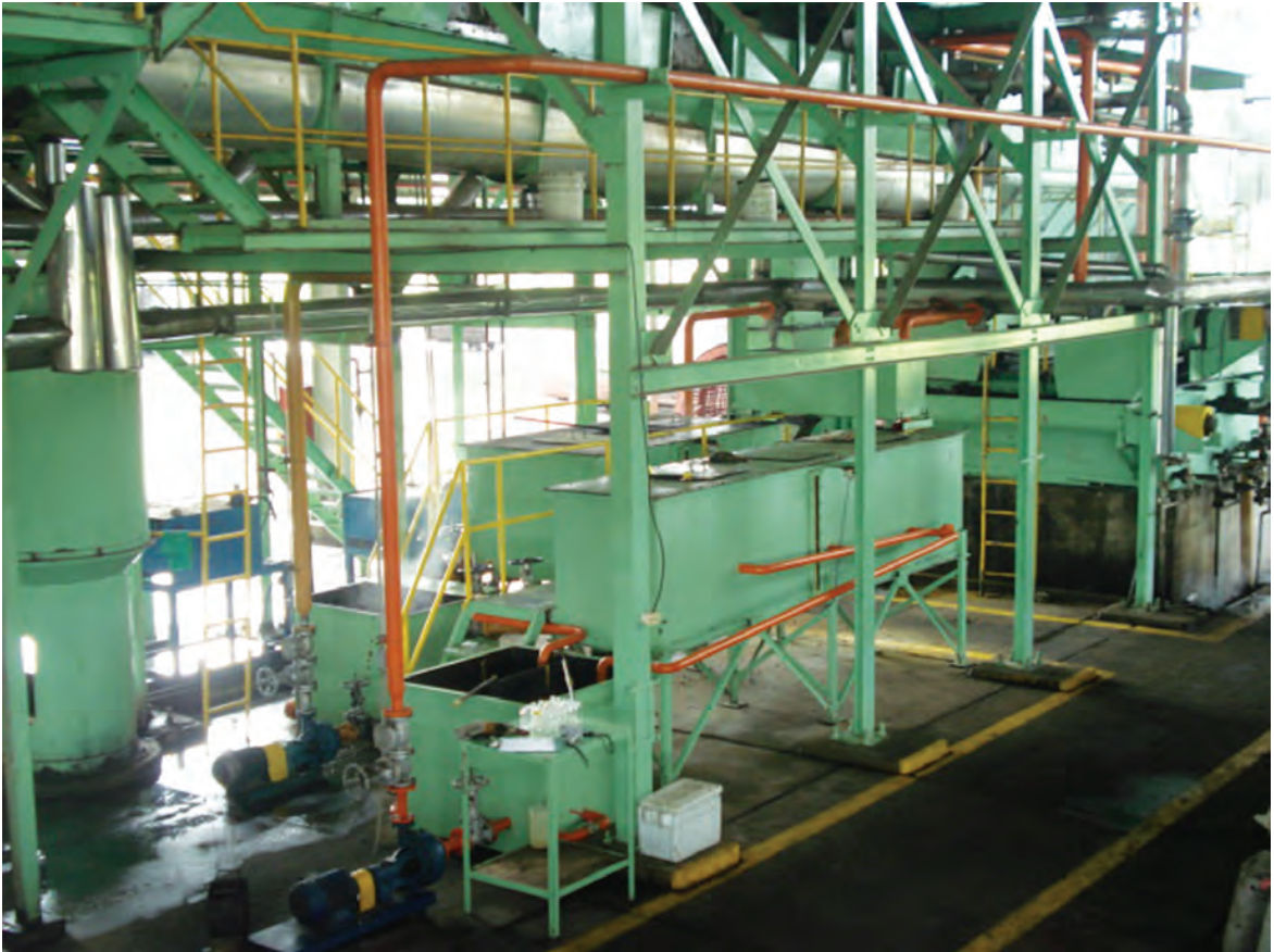
Operación de preclarificador
