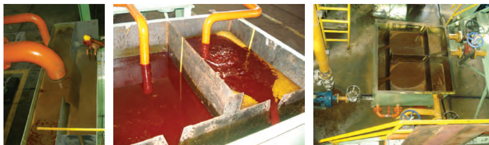
Figura 25. Vertederos de licor de prensa, aceite preclarificado y lodos preclarificados.
