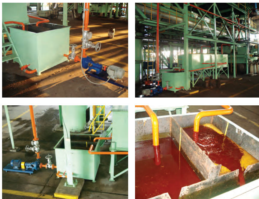
Figura 24. Tanque de bombeo de aceite preclarificador.
